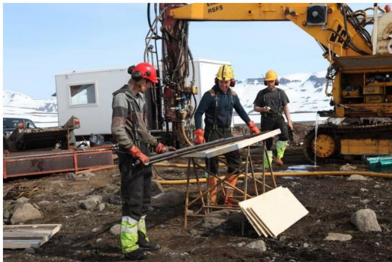
Mynd 4.2. Borinn var fluttur á borstað 17. júní og á myndinni eru boranir komnar af stað í veðurblíðu þann 26 júní 2014.
